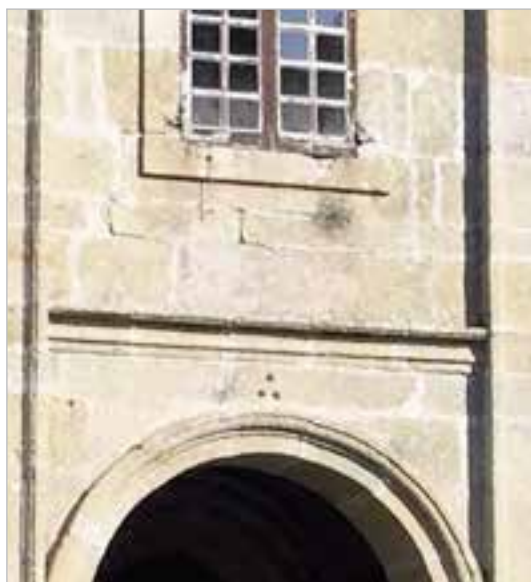
Marcas de tres buratos sobre o arco central da panda Leste do claustro
