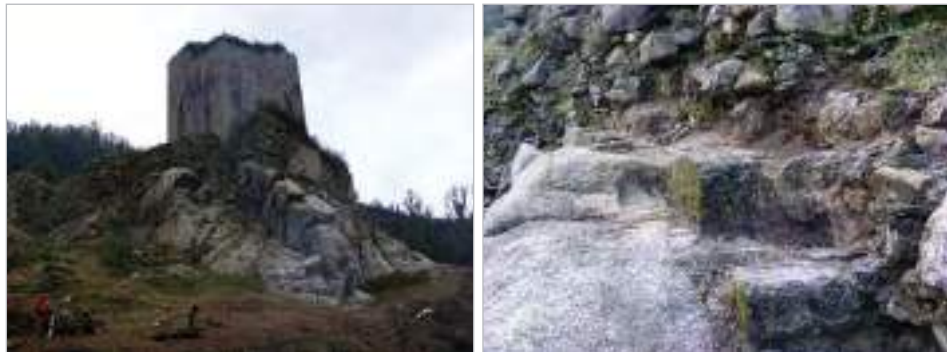
Figs. 50, 51. Estado previo da camisa antes da consolidación e detalle da súa acomodación á rocha do substrato
